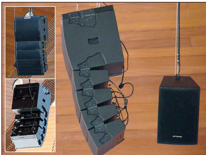
No detalhe, as caixas do sistema Line Array, que tornaram o som no interior do templo mais inteligível
